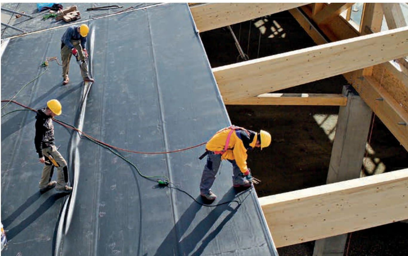
Pokrycie w postaci folii PVC | Folia EPDM kauczukowa | Element dachowy z profilowaną łukową blachą aluminiową
